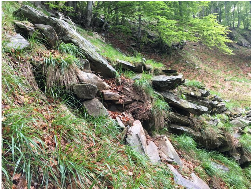
Figura 1: Sentiero in pessime condizioni e parzialmente compromesso a causa delle recenti piogge torrenziali
